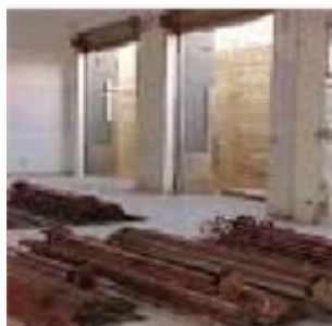
Terminati i lavori, il cantiere viene smobilizzato, in particolare vengono rimossi ed allontanati gli elementi di recinzione e di delimitazione provvisoria di cantiere, gli arredi e la segnaletica utilizzata, dopo si procede alla pulizia finale dell'area
